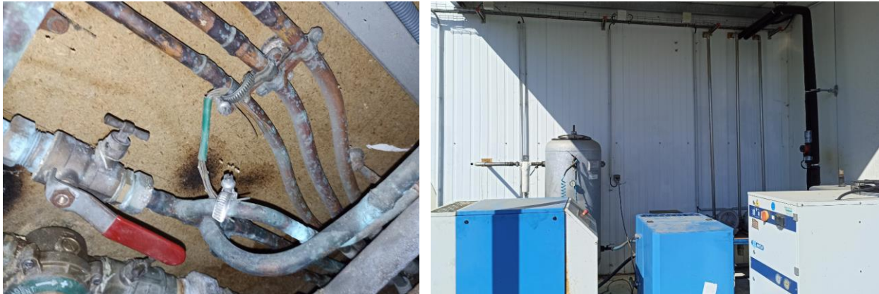
Figure 12 : Mise à la terre canalisation cuivre eau froide + Compresseur et canalisation air comprimé
