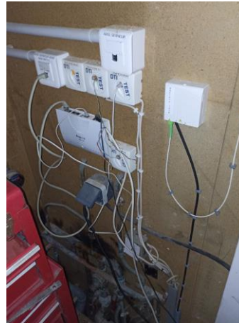
Figure 8 : Arrivée télécom et fibre optique bâtiment 1
