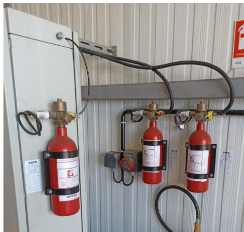
Figure 9 : Extinction automatique armoire process bâtiment 2
